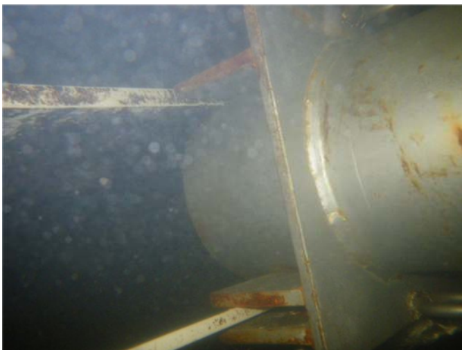
Zdjęcie 5. Widok z wody na zamieszczony metalowy element do wprowadzania ryb, zachodzący na metalowe szprychy wieńca kierownic turbiny
