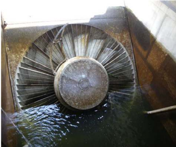
Zdjęcie 1. Turbina VLH elektrowni śluzy w Frouard podczas opróżniania komory wody
