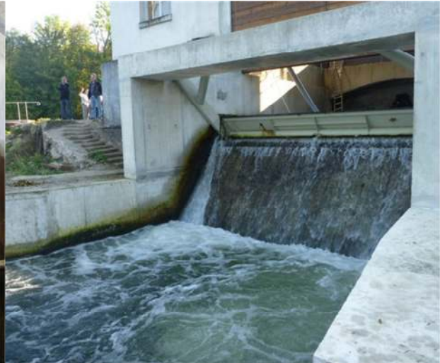
Zdjęcie 2. Ujście wody z działającej turbiny VLH w Frouard
