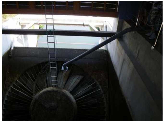
Zdjęcie 4. Widok na rurę tłoczącą połączoną z metalowym elementem zainstalowanym na wieńcu kierownic VLH, komora wody pusta
