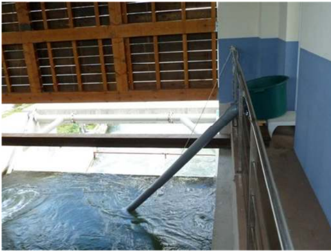
Zdjęcie 3. Zbiornik z wodą połączony z rurą PVC umożliwiającą podawanie węgorzy bezpośrednio do kierownic turbiny
